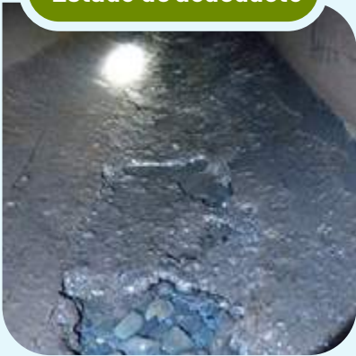
Estado de acueducto
