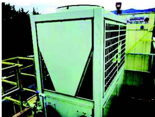
Fotografía N° 4: Bomba de Calor.
