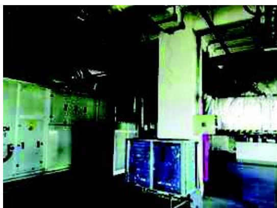
Fotografía N° 5: Manejadora de Aire.
