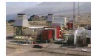
Turbina a gas, 120 MW conversión a ciclo combinado
